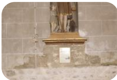
Trace en escalier sur le mur
